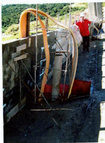
Foto 6.5.8.1: Percolação de água
